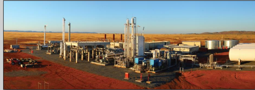
Operating GE small-scale LNG plant
